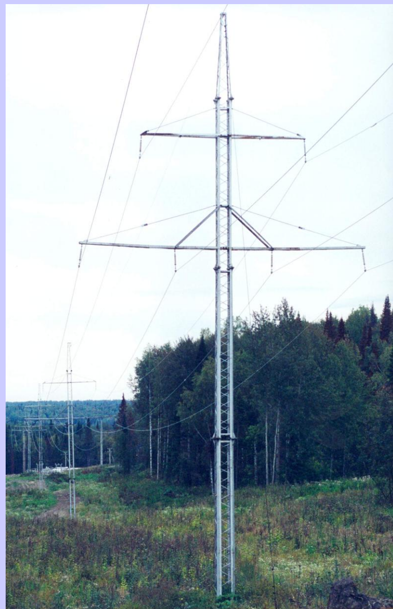
Двухцепная ВЛ 35 кВ на ПС «Верхняя» (ООО «РОВЕР», (Кемеровская область))
